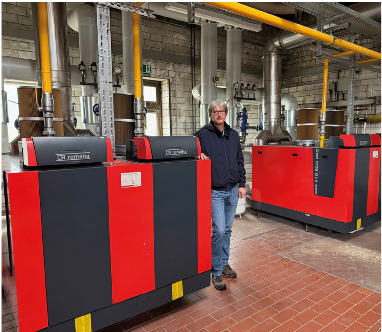
Ingenieur Ingo Michaelis in der Lobetaler Heizzentrale
